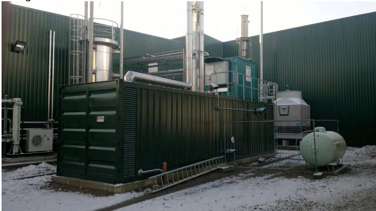
Abbildung 5: Deponiegasverbrennung DGV 100 mit Abhitzekessel und Biogasverdichter
