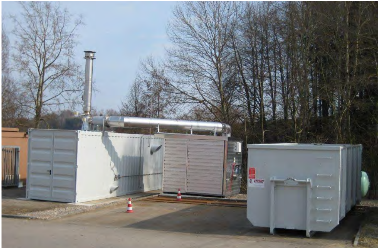
Abbildung 6 Deponiegasverbrennung Ringenbach mit Hackschnitzeltrocknung
