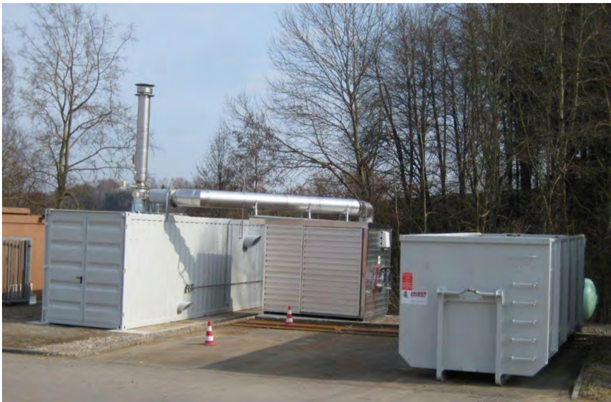
Bild 3: Deponiegasverbrennung mit Hackschnitzeltrocknung
