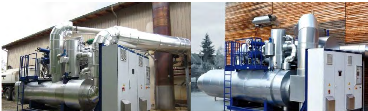
Bild 4: ORC-Anlagen der Firma Dürr; 70 kW links, 100 kW rechts
