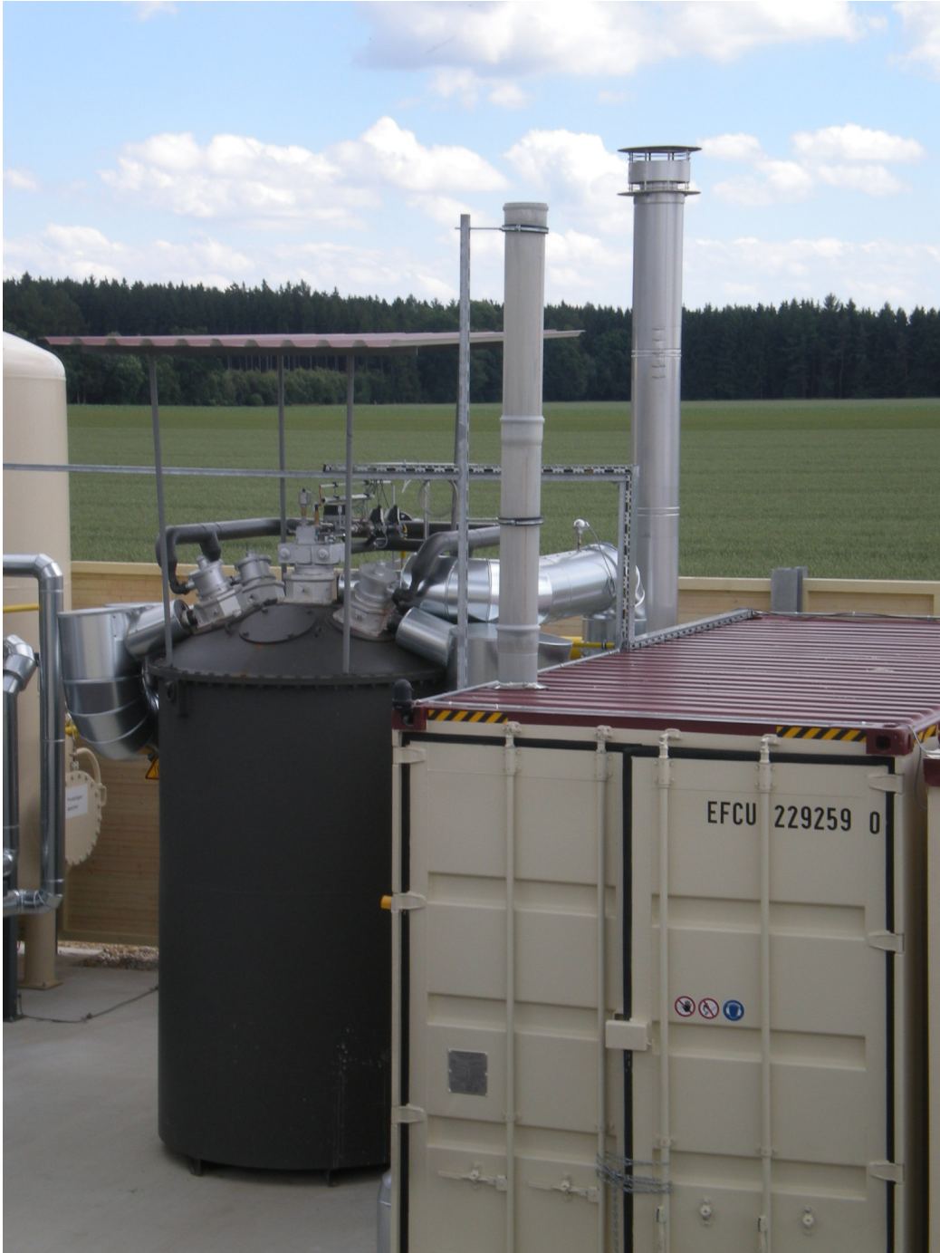
SGV 300 mit Brennwertkessel im Container
